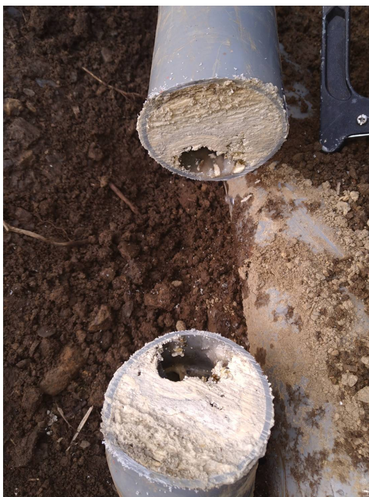
Fig. 1. 管線內部嚴重結石
