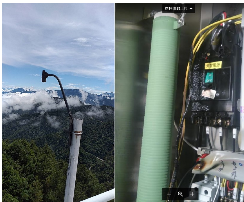
Figure 10: 圓頂上方風速風向計與開關箱內火燒情形
